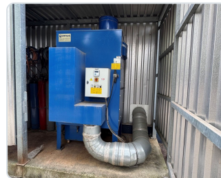
Filter- und Absauganlage
